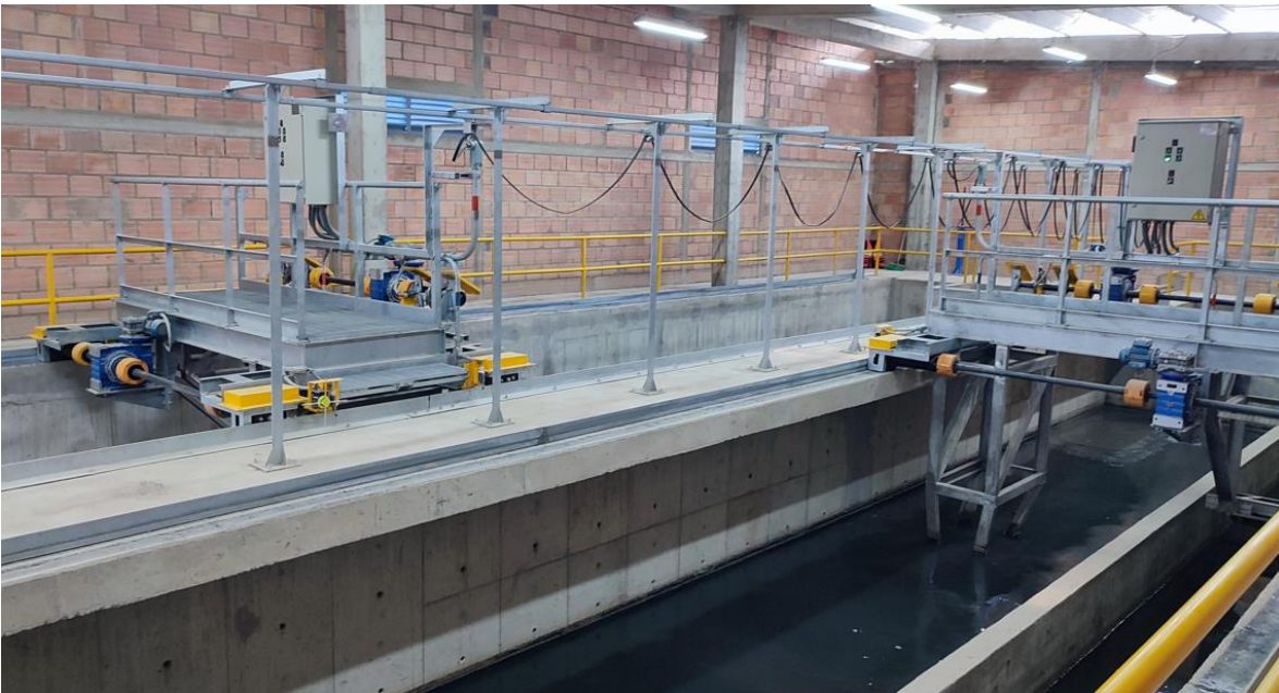
Ilustración 16. Canales de Desarenado – Desengrasado con sus puentes barredores
