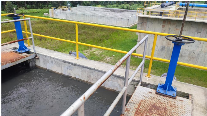
Ilustración 20. Válvulas de compuerta de 20" de Paso de Tratamiento Primario a Reactores
