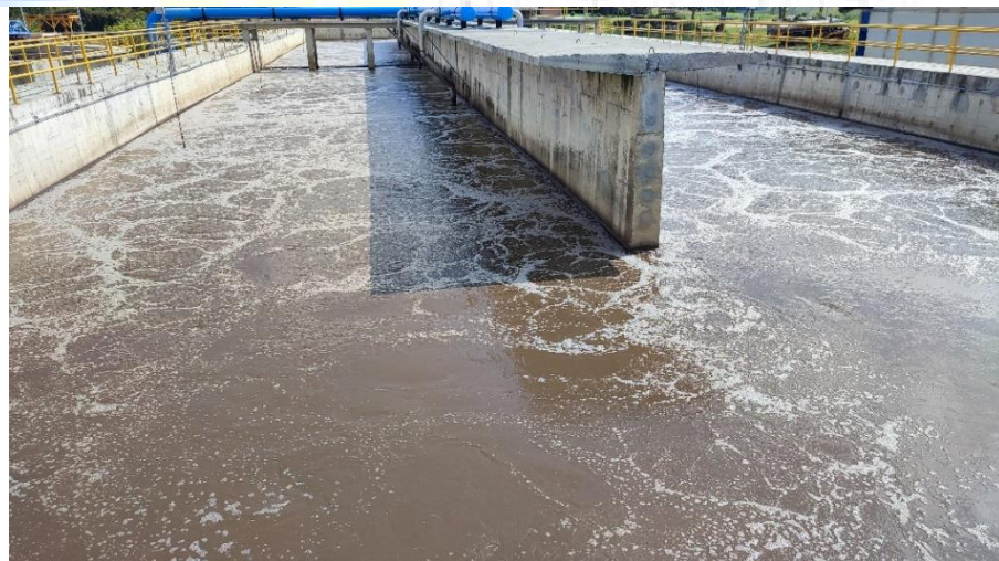
Ilustración 24. Fotografía Reactor de Aireación Extendida en condición estabilizado
