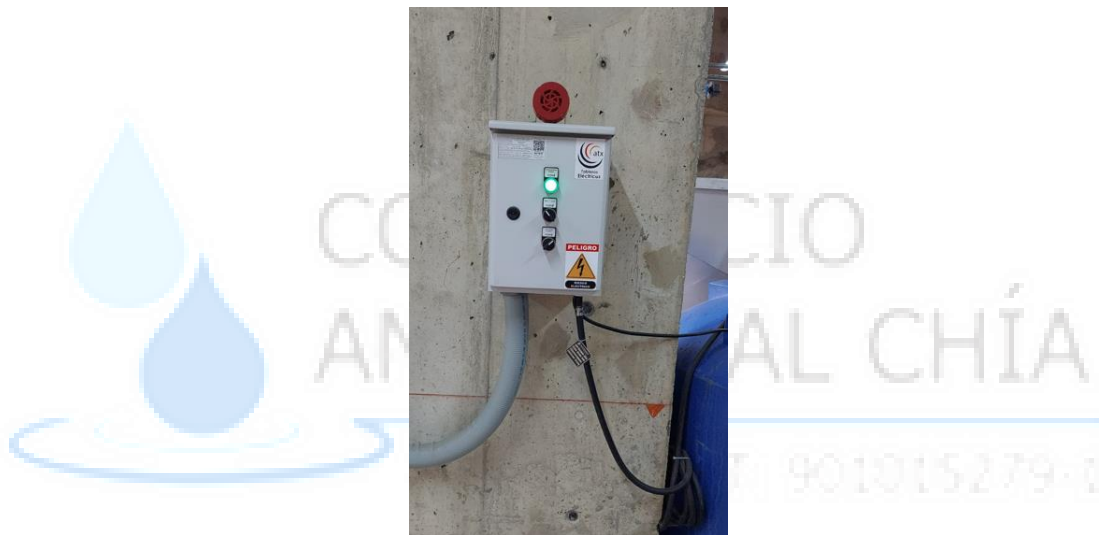
Ilustración 19. Tablero de Control y Operación Bomba de Excesos de la extracción y clasificación de arenas.
