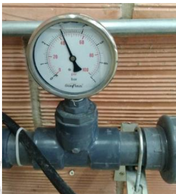
Ilustración 34. Manómetro de presión Manifold mezclador de cloro gaseoso.
