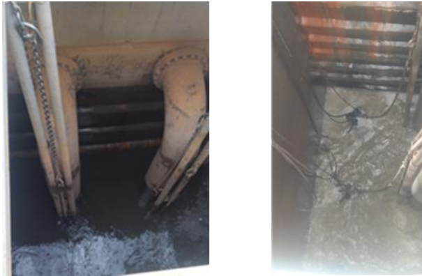
Ilustración 10. Cámara de Bombeo en Operación
