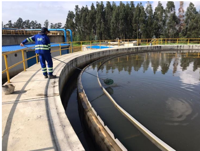
Ilustración 28. Proceso de retiro de sobrenadantes y partículas flotantes en los Sedimentadores secundarios
