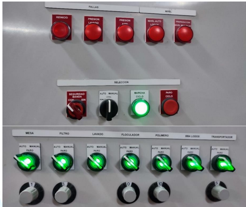
Ilustración 46. Tablero de Operación Equipo EMO (Espesamiento, Deshidratación)
