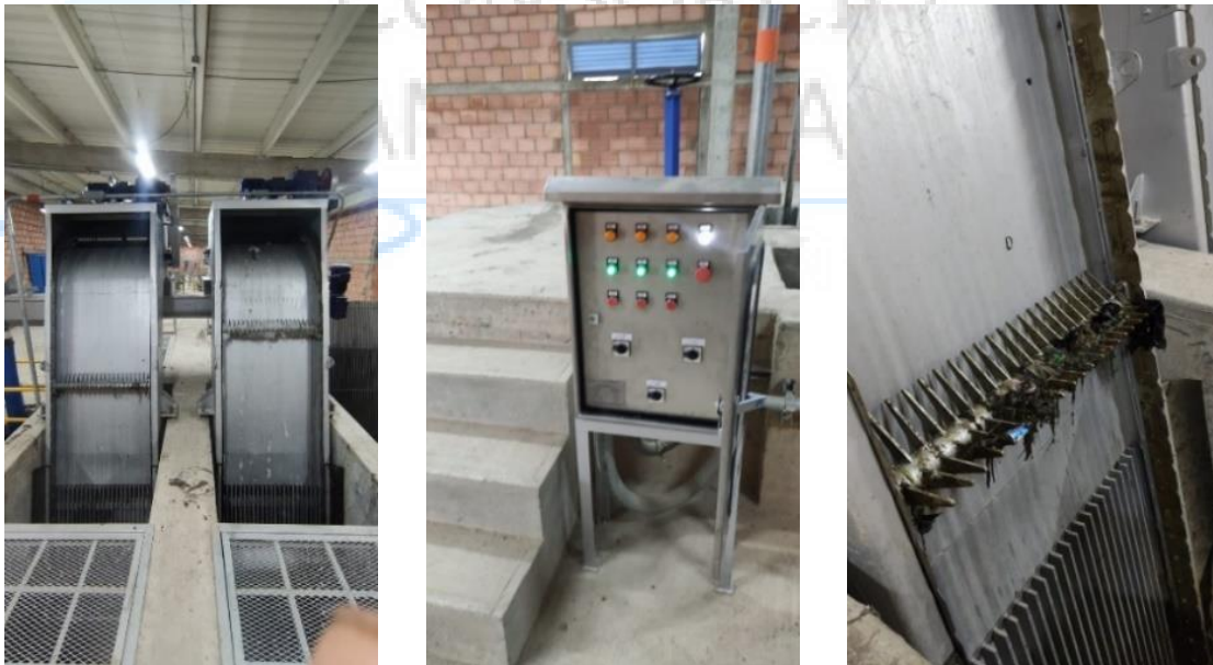
Ilustración 13. Rejas Mecánicas Desarenador
