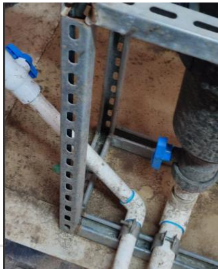
Ilustración 30. Válvulas de Purga en Filtro Banda y Reguladoras de presión
