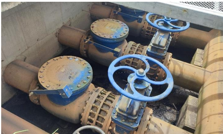
Ilustración 12. Fotografía Manifold EBAR con sus respectivas válvulas anti retorno, unión autoportante y válvula de corte de 20".
