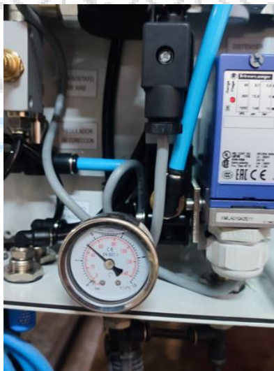
Ilustración 45. Manómetros Presión de Bandas y Agua de Lavado del Equipo EMO
