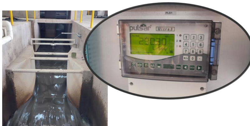
Ilustración 15. Canaleta Parshall 36" Desarenador
