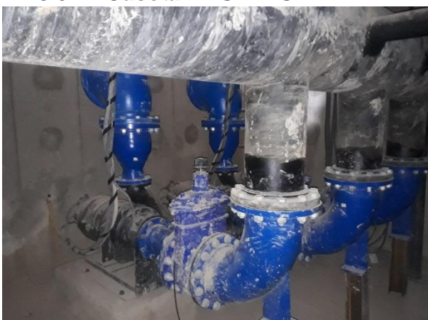
Ilustración 39. Manifold Succión RAS bomba S1.4
