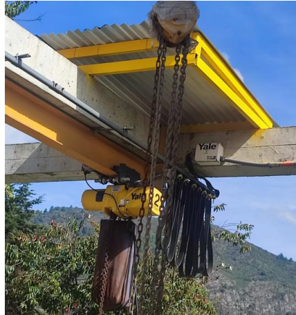
Ilustración 11. Polipasto mecánico para retiro de bombas
