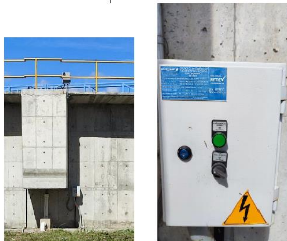
Ilustración 29. Cámara de Espumas y Tablero de Operación
