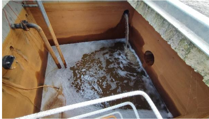
Ilustración 51 Planta Elevadora de Excesos
