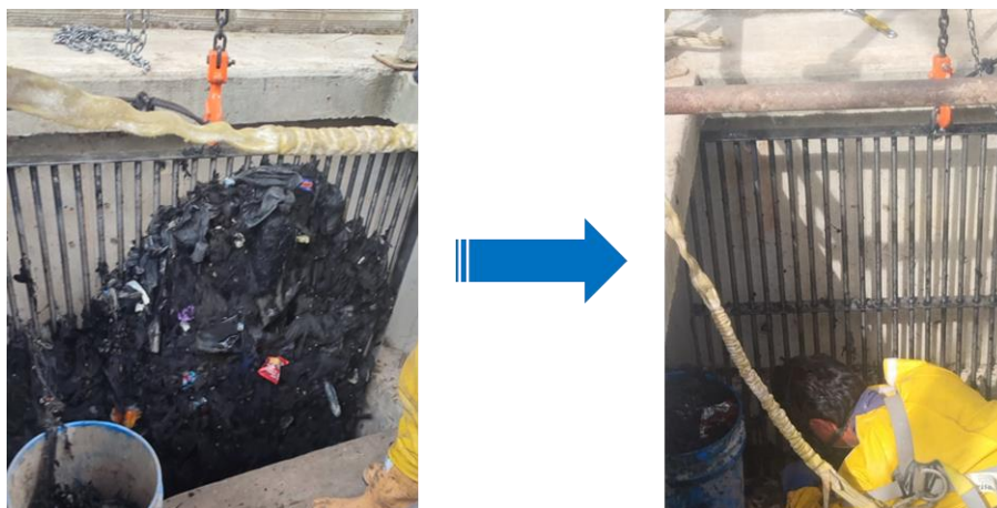
Ilustración 7. Proceso de Limpieza de la Rejilla Deslizante
